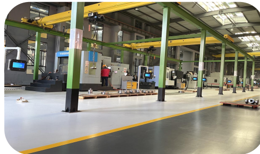
産業用電気設備
